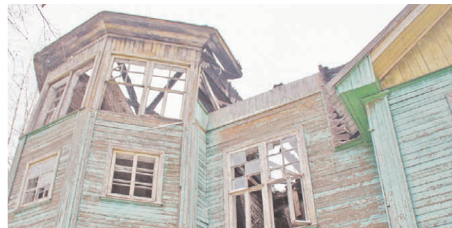
Здание почти полностью разрушено
